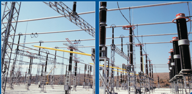
Automatisation des Systèmes d'Énergie
